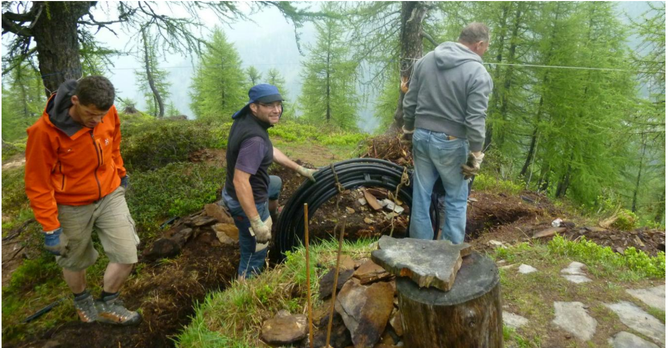
Zuleitung zur neuen Wasserturbine
